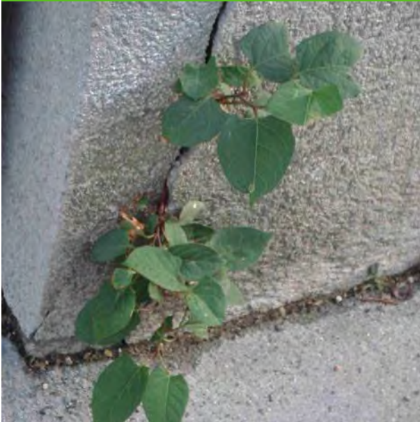
Dickenwachstum sprengt Mauerwerk
